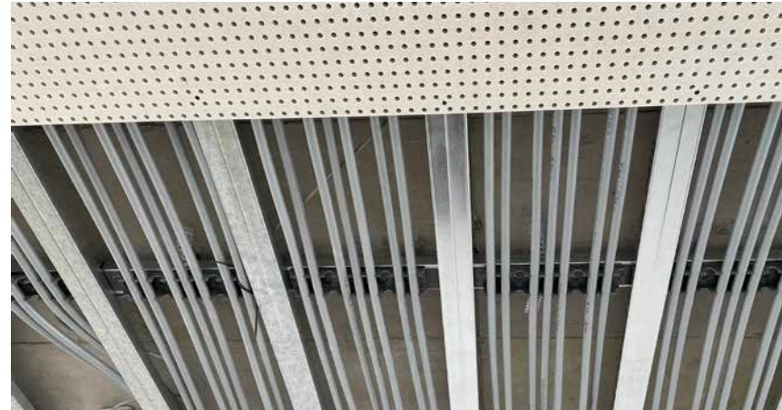
Sehr geringe Wartungs- und Betriebskosten beim geschlossenen Wassersystem
